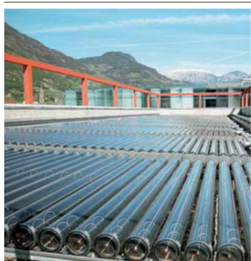
Energia pulita Impianto fotovoltaico sul tetto dell'Eurac
