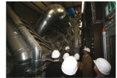
Gas- und Dampfturbinenkraftwerk in Hamm-Uentrop
