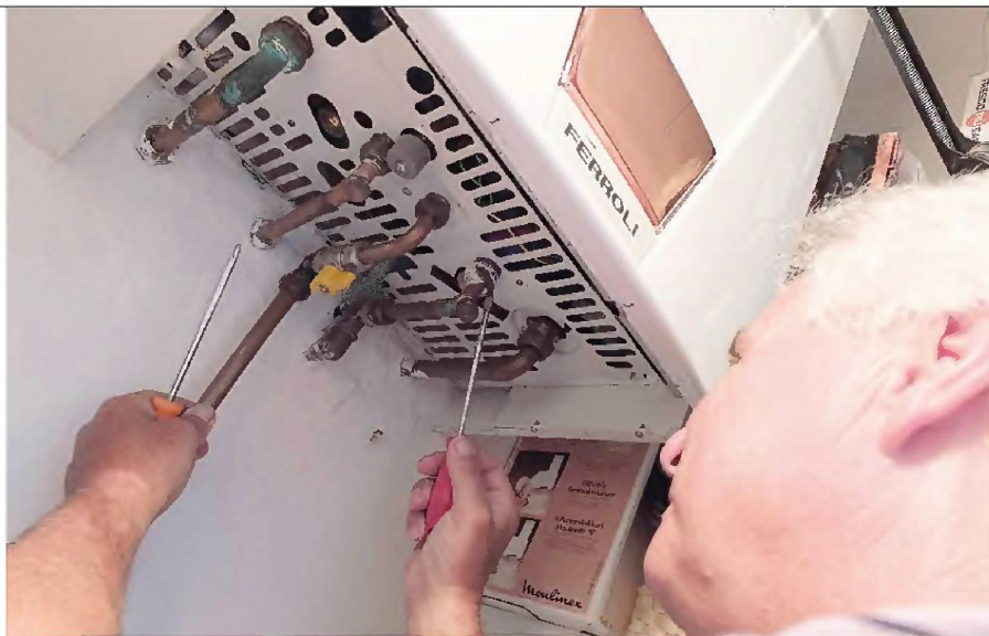
Il controllo di una caldaia effettuato da un manutentore autorizzato
